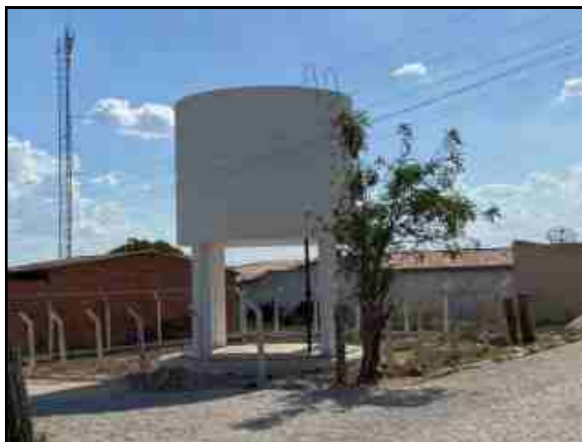
Figura 49 – Reservatório R04 – em operação Fonte: Premier Engenharia, 2021.
