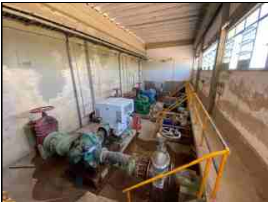
Figura 35 – Conjuntos motobombas ERAB-2 Fonte: Premier Engenharia, 2021.
