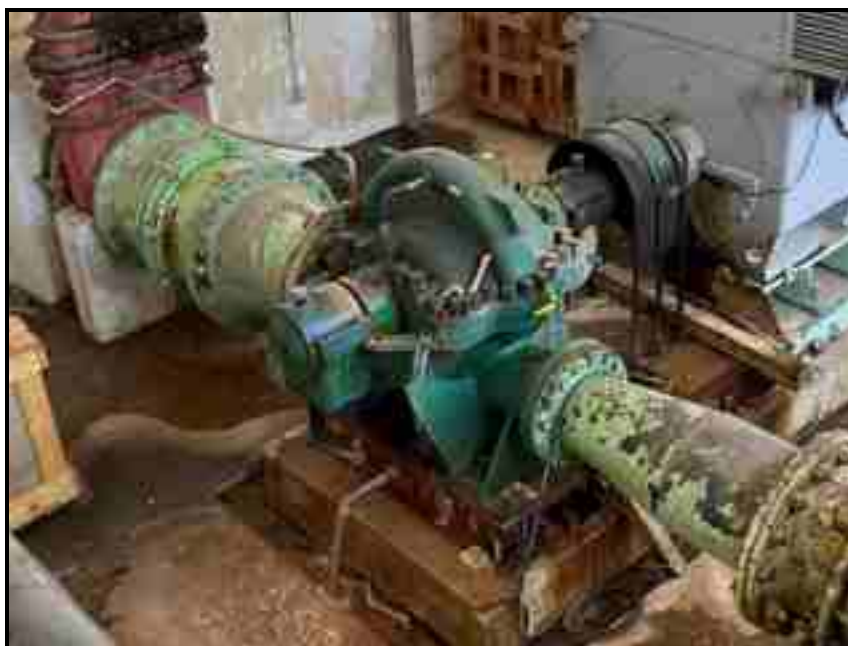
Figura 82 – Vazamento Conjunto Motobomba -ERAT 1 Fonte: Premier Engenharia, 2021.
