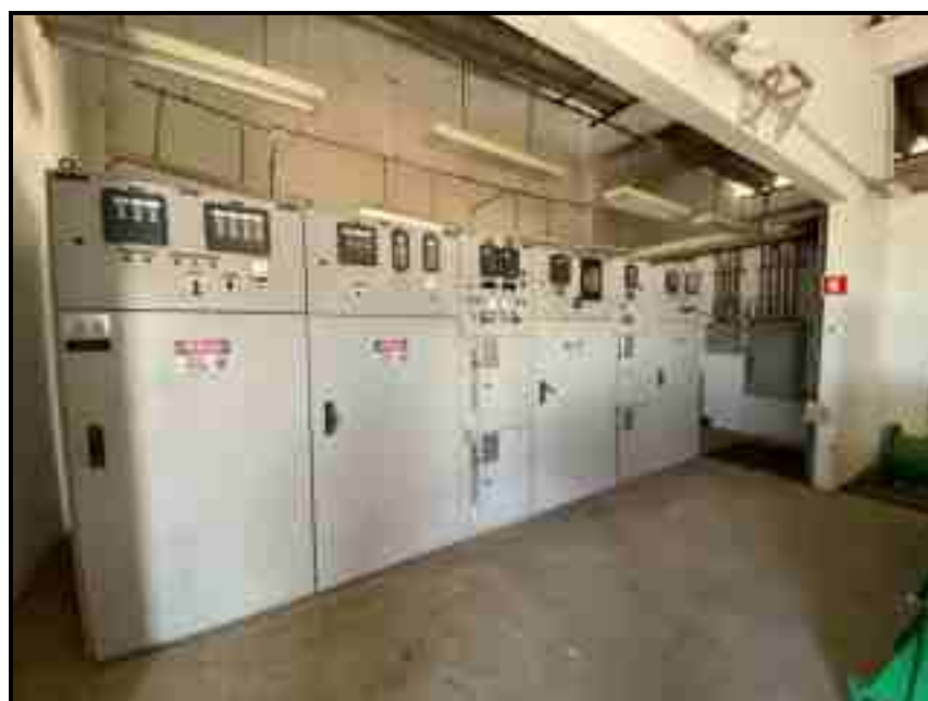
Figura 44 - Quadro de comando ERAT-1 Fonte: Premier Engenharia, 2021.
