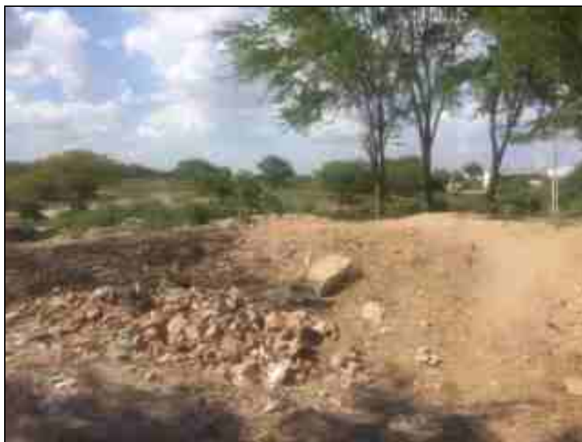
Figura 130 – Contenção às margens do Riacho Grande Fonte: Premier Engenharia, 2021.
