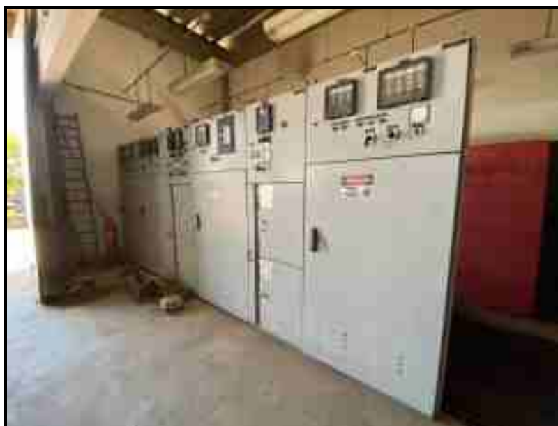
Figura 36 – Quadro de comando ERAB-2 Fonte: Premier Engenharia, 2021.
