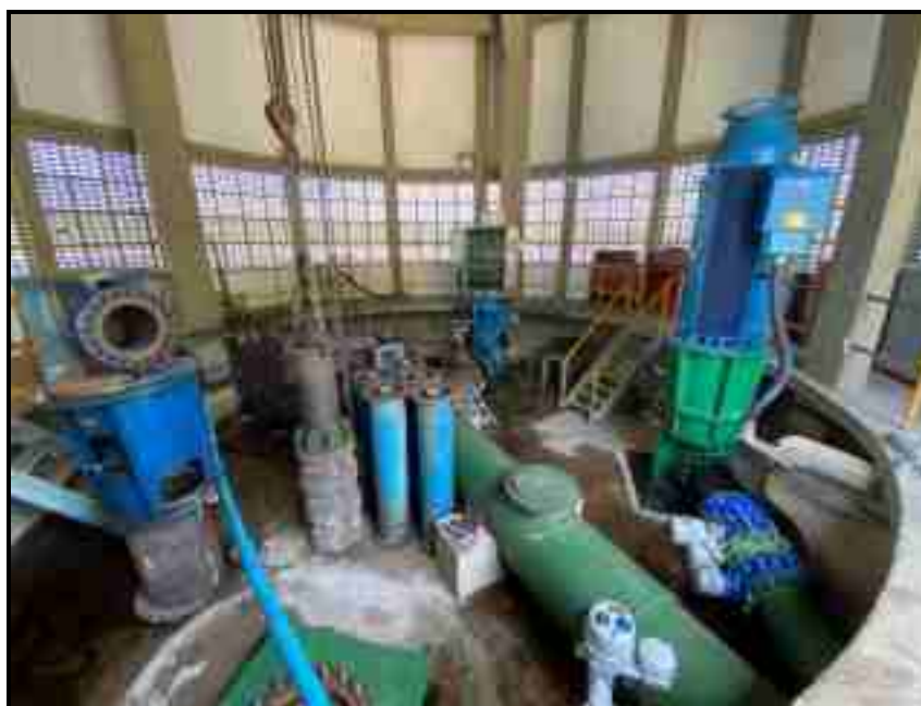
Figura 33 – Conjuntos motobomba ERAB-1 Fonte: Premier Engenharia, 2021.
