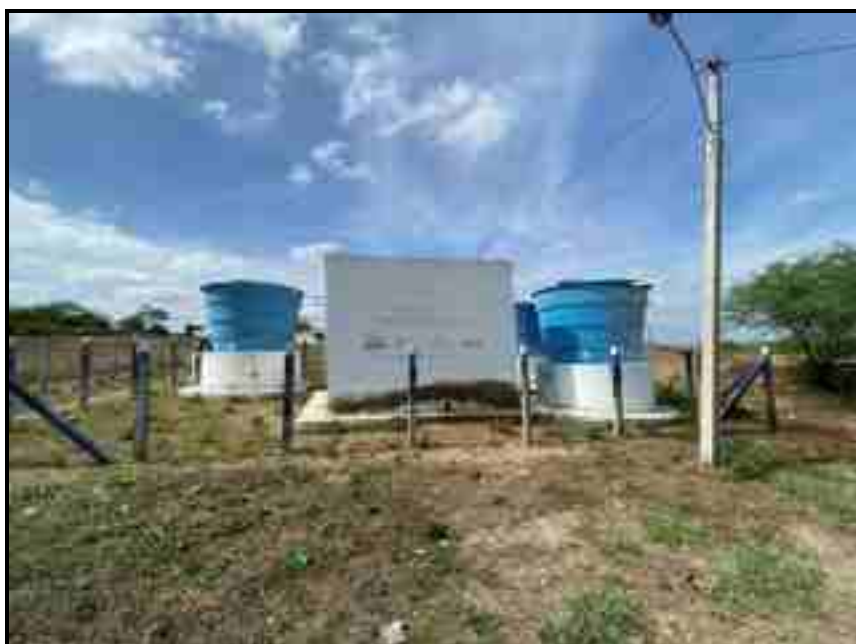
Figura 72 – Vista Sistema Abastecimento 1 – Povoado Serrinha dos Cocos Fonte: Premier Engenharia, 2021
