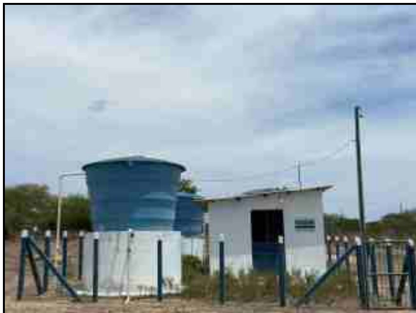
Figura 65 – Dessalinizador – Sítio Pedra D'água dos Alexandres Fonte: Premier Engenharia, 2021.
