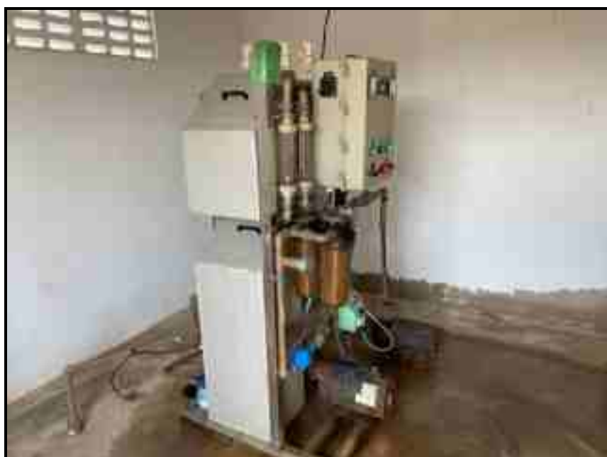
Figura 73 – Dessalinizador Sist. 1 – Povoado Serrinha dos Cocos Fonte: Premier Engenharia, 2021
