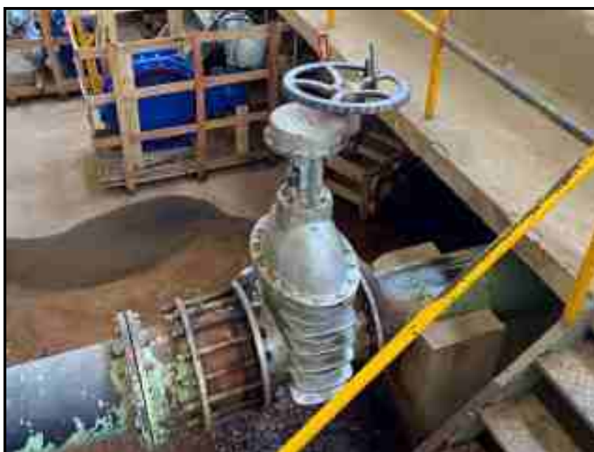
Figura 38 – Vazamento no registro ERAB-2 Fonte: Premier Engenharia, 2021.
