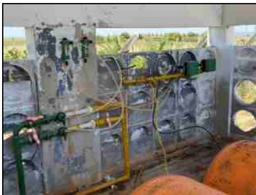
Figura 41 – Dosadores de cloro gasoso Fonte: Premier Engenharia, 2021.
