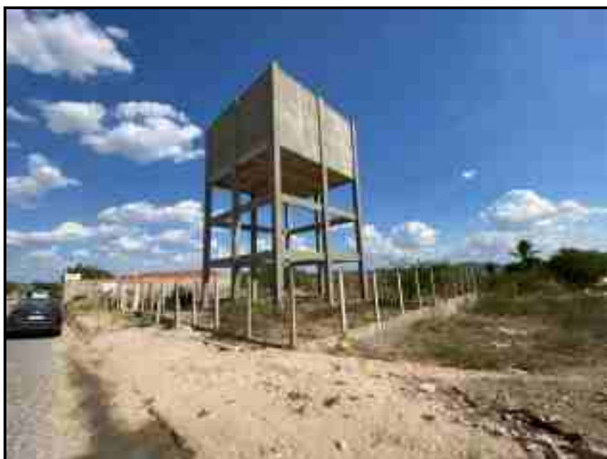
Figura 80 – Reservatórios R-05 – Senador Rui Palmeira Fonte: Premier Engenharia, 2021.
