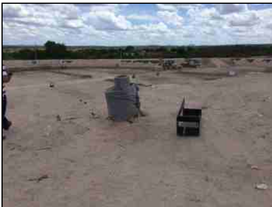
Figura 109 – Dreno de gás Fonte: Premier Engenharia, 2021.
