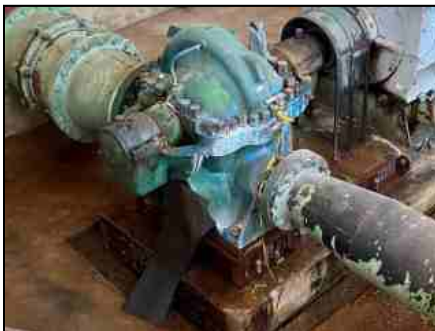
Figura 37 – Vazamento no conjunto Motobomba ERAB-2 Fonte: Premier Engenharia, 2021.
