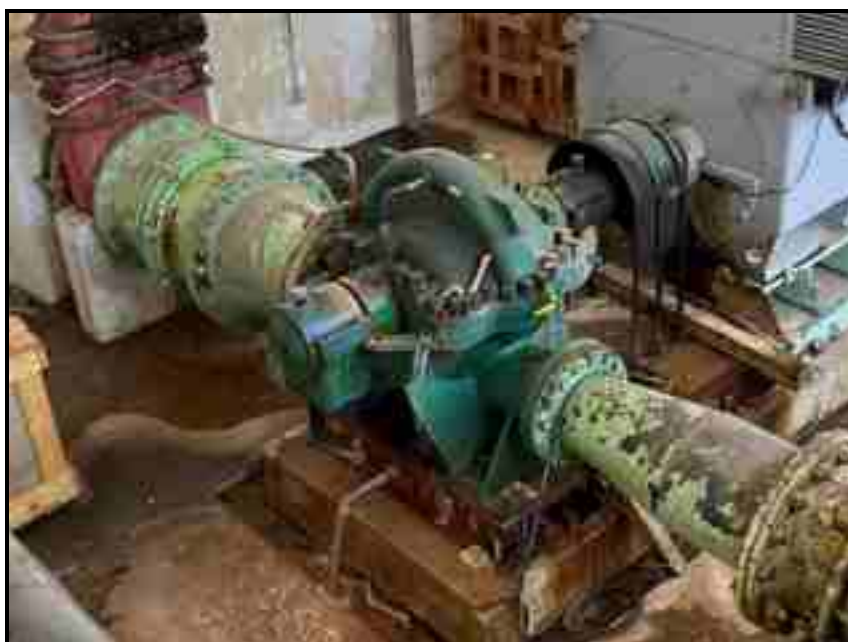
Figura 45 - Vazamento no conjunto Motobomba ERAT-1 Fonte: Premier Engenharia, 2021.
