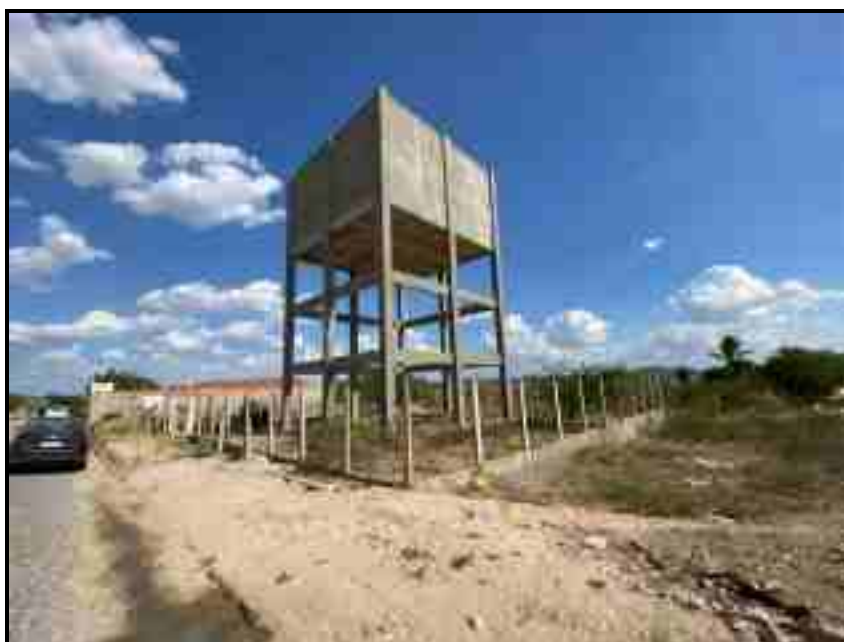
Figura 50 – Reservatório novo – não operando Fonte: Premier Engenharia, 2018.
