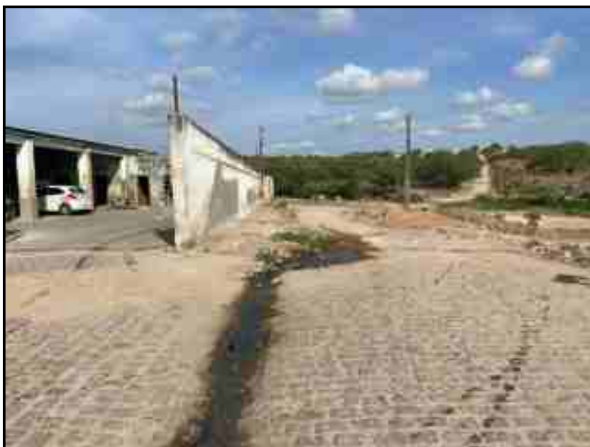
Figura 86 – Lançamento de Esgoto próximo ao Transbordo de Resíduos Fonte: Premier Engenharia, 2021.
