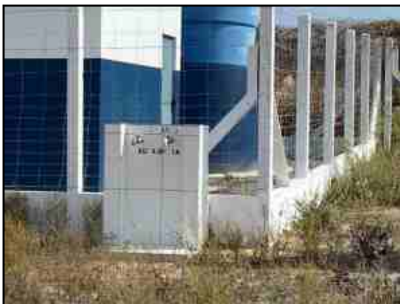
Figura 56 – Chafariz – Sítio Baixa da Boneca (São José) Fonte: Premier Engenharia, 2021.
